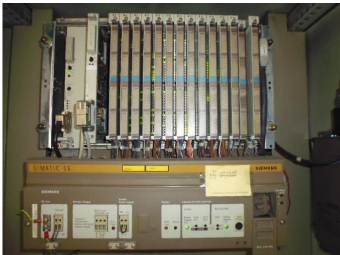
Bild aktuelle Anlage
